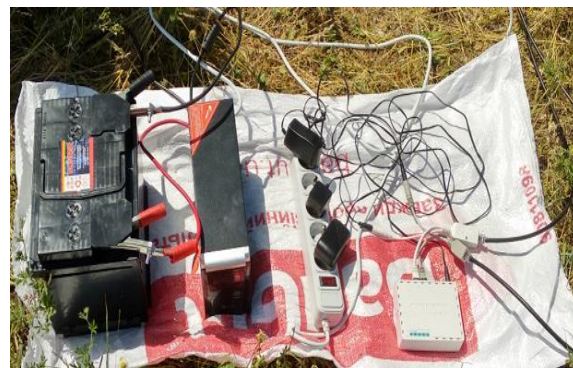
Автономне живлення засобів безпроводового зв'язку та маршрутизатор
